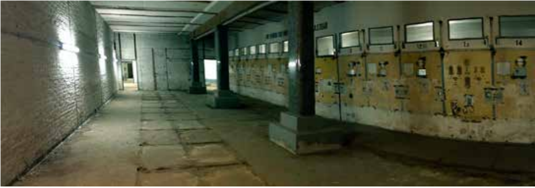
Abwicklung eines Panoramafotos – Bereich Marmorsäulen mit nachträglich eingebrachten Wänden durch die BEWAG.
